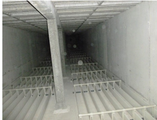
Foto 3: Evenwijdige lamellen van koeldekstelsysteem in mestkelder onder de rooster (bij installatie)
